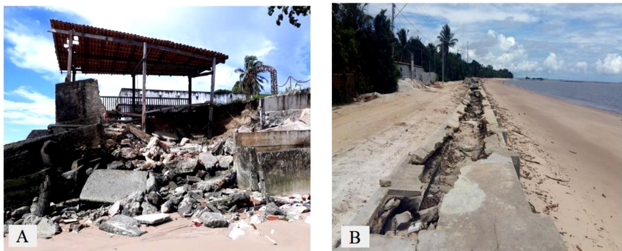
Figura 15- Impactos da erosão costeira em praias da Ilha de Mosqueiro: (A) residência destruída na Praia Grande; (B) muro de arrimo danificado na Praia do Marahú
