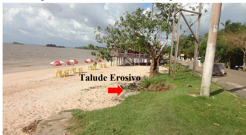
Figura 16 - Erosão na margem fluvial da Praia do Paraíso (seta), registrado antes da construção da nova orla
