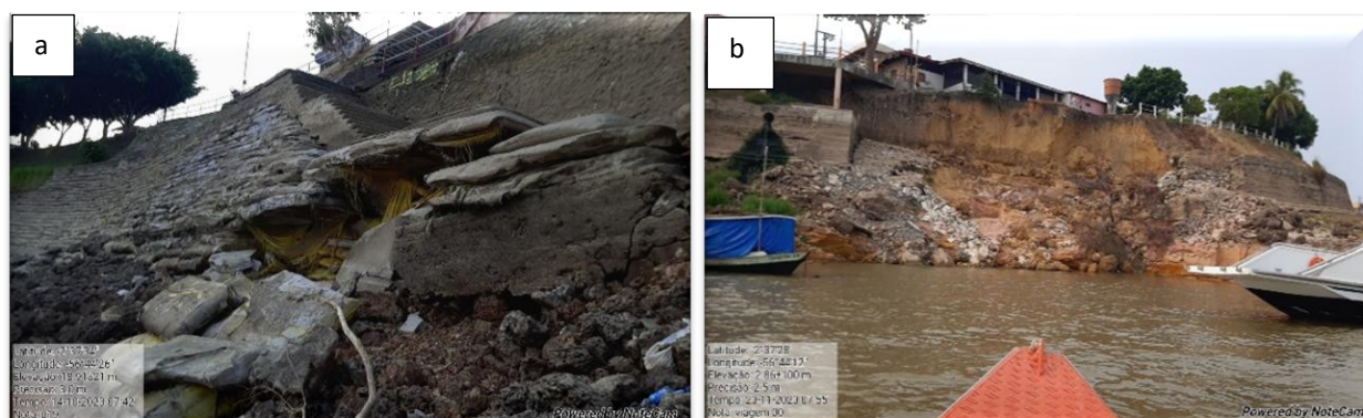
Figura 03: Erosão Fluvial frente de Parintins-AM
