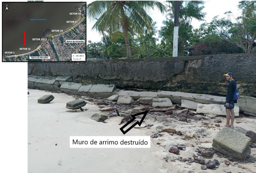
Figura 8 – Destruição de construções por agentes físicos.
