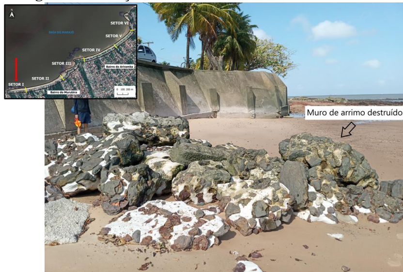
Figura 7 – Pedacos de Muro de Arrimo na Zona de Estirâncio
