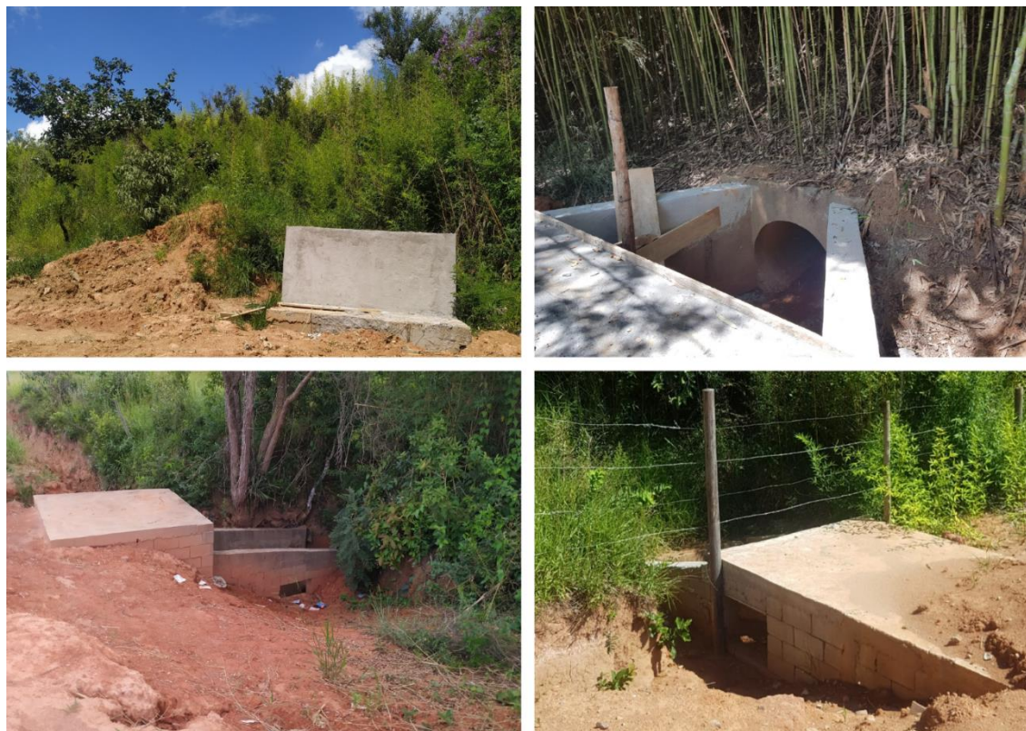
Figura 8 - Pontos 1, 2, 5 e 6 com a presença de manilhas de águas pluviais e impactos na vertente leste.
