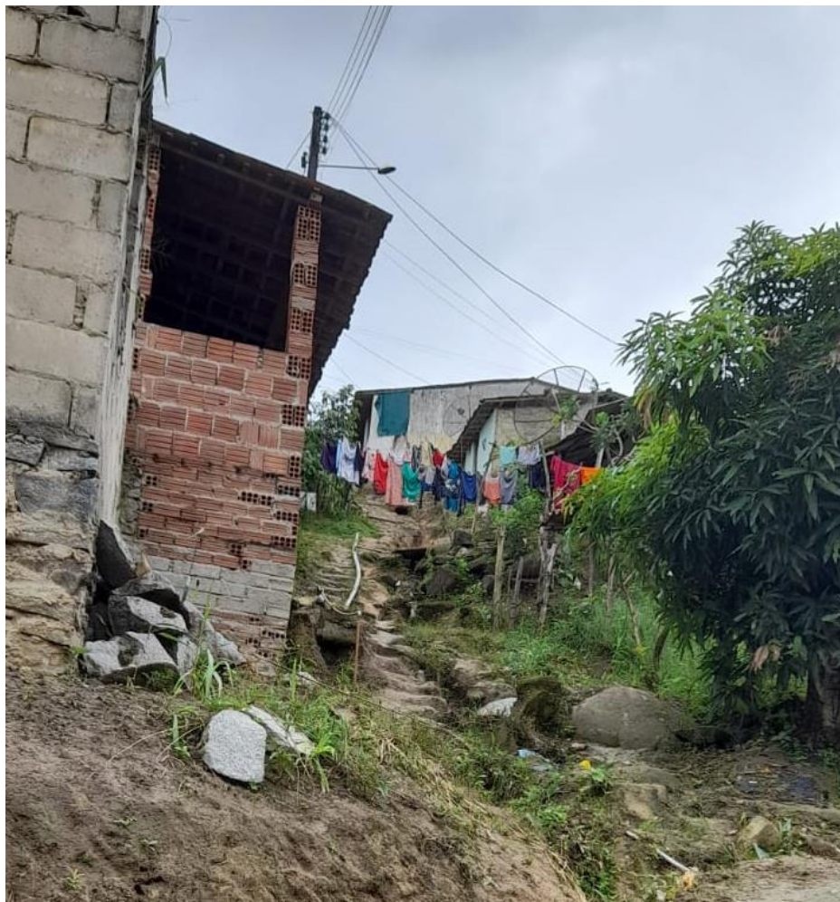
Figura 7 – Viela do bairro Alto São Simeão – os canos são usados para despejos de efluentes das residências
