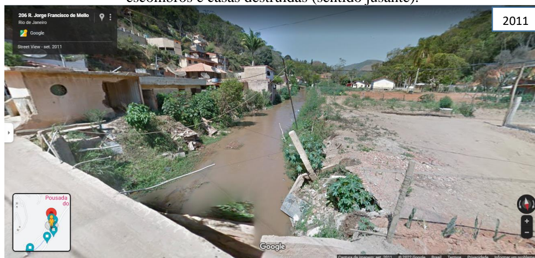
Figura 8. Planície do rio Cuiabá no Ponto 3, em 2011, com margens expostas, acúmulo de escombros e casas destruídas (sentido jusante).
