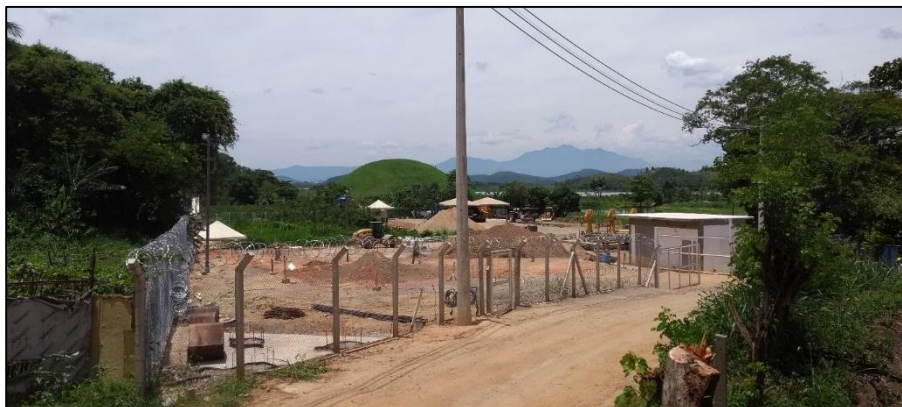
Figura 12: Canteiro de obras para construção dos poços da empresa TKCSA, distante 20 Km da sede da empresa
